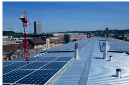
Die aufgestockte Halle 181 trägt als erster Lagerplatz-Bau eine Photovoltaik-Anlage. Weitere auf anderen Gebäuden werden folgen.
